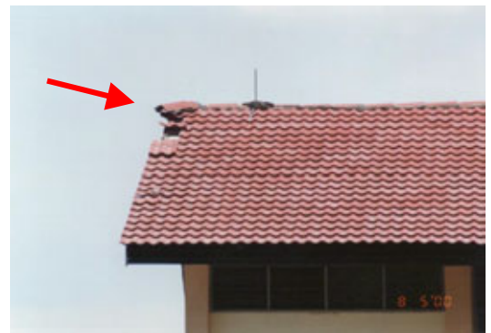
Figura 9: Fotografía de un punto de impacto en el extremo de la cumbrera del techo a dos aguas. La instalación de la punta Franklin debería haber sido justo sobre el extremo de la cumbrera, en lugar de colocarla a una distancia aproximada de 1 m.
