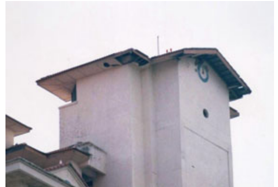
Figura 5: Fotografía de edificio de departamentos Setapak Ria que muestra terminal captador ESE de fabricación francesa y el punto de impacto
