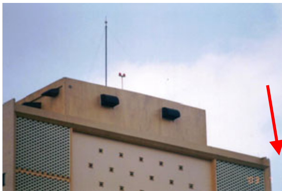
Figura 4 Fotografía del edificio Wisma Tanah tomada en 2003. El edificio había sido impactado por un rayo, como puede verse a la derecha
