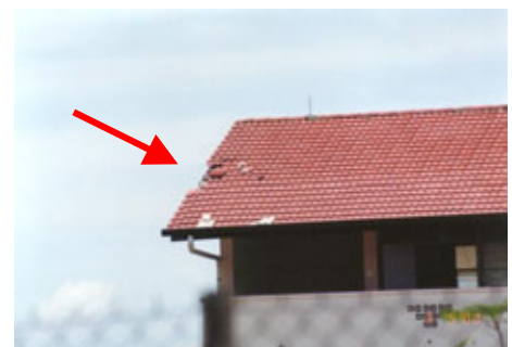
Figura 10: Fotografía de un punto de impacto en el borde de inclinación del techo a dos aguas. El derivador del terminal captador también tendría que haber sido instalado en los bordes del techo a dos aguas.
