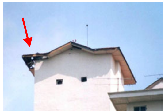
Figura 6: Fotografía del otro edificio de departamentos Setapak Ria que muestra otro terminal captador ESE de fabricación francesa y el punto de impacto.
