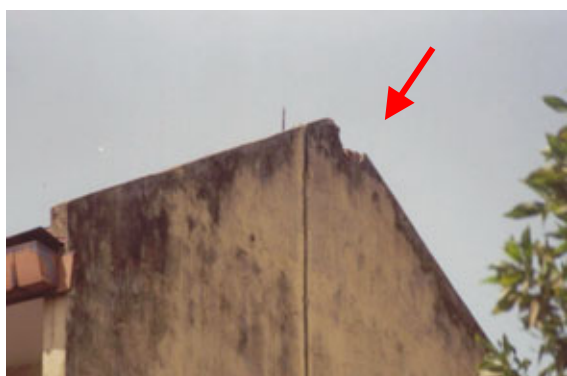
Figura 12: Primer plano de otro bloque de departamentos que muestra el punto de impacto y la punta Franklin instalada al lado. Para una protección eficaz, la punta debe estar posicionada inmediatamente arriba de los extremos de la cubrera y lugares de alto riesgo similares.
